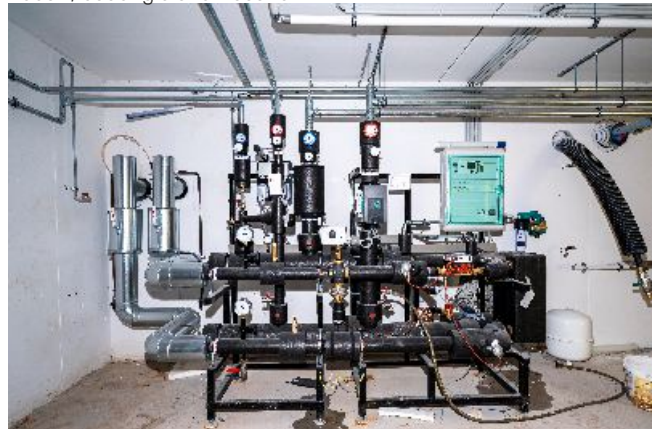
Haus 7, UG Fernwärme-Übergabestation
