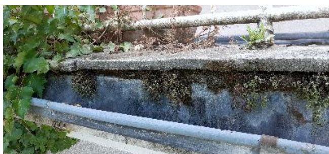
Balkondetail Haus 14: vorher...
